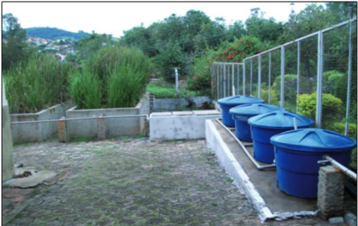
Figura 5 – Estação de Tratamento de Efluentes (ETE) do Laticínio do IFSULDEMINAS, campus Inconfidentes/MG
