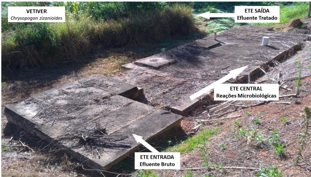
Figura 4 – Estação de Tratamento de Efluentes (ETE) do Laticínio do IFSULDEMINAS - Campus Machado (MG)
